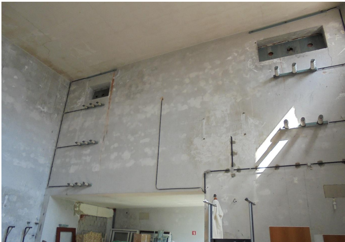
Prostor 10 kV in 35 kV stikališča
